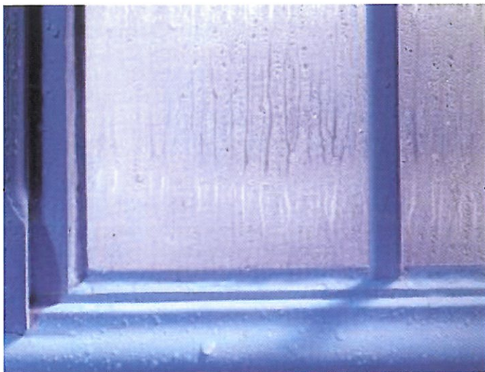
Condensazione del vapore acqueo sul vetro di una finestra
